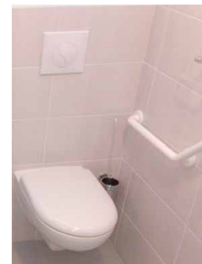
Exemple de cuvette suspendue dans un sanitaire accessible
