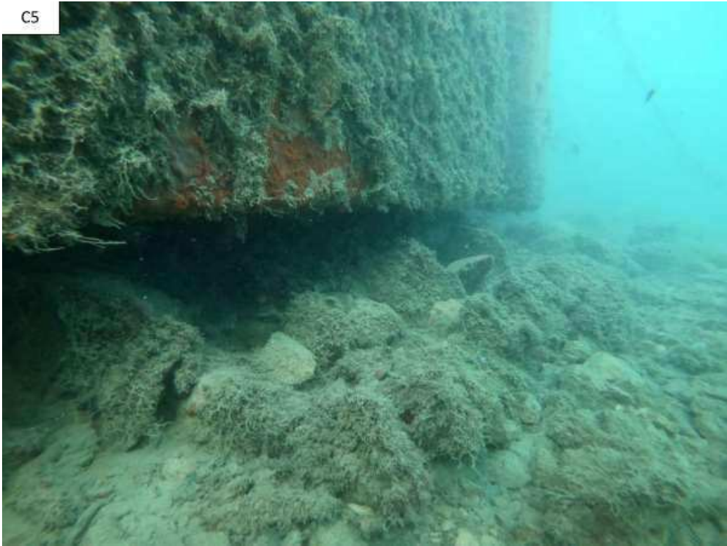
Figure 7: photographie de l'affouillement C5
